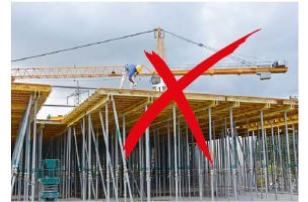
2 Verboten: Deckenschalung ohne Absturzsicherung bei grosser Absturzhöhe
