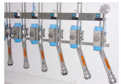
Abfüllstelle bei einer ortsfesten Tankanlage (Firma Halag, Kt. Thurgau)
