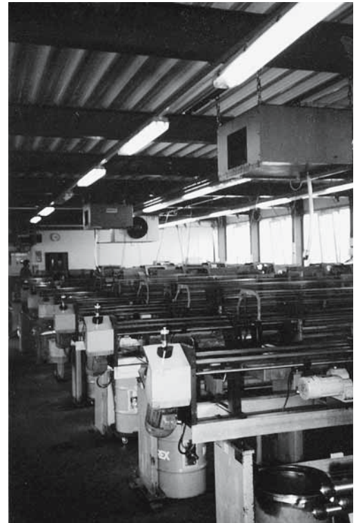
Décolletage-Werkstatt mit künstlicher Raumlüftung. Die Luft wird nach der Filtration wieder in den Arbeitsplatzbereich zurückgeführt.
